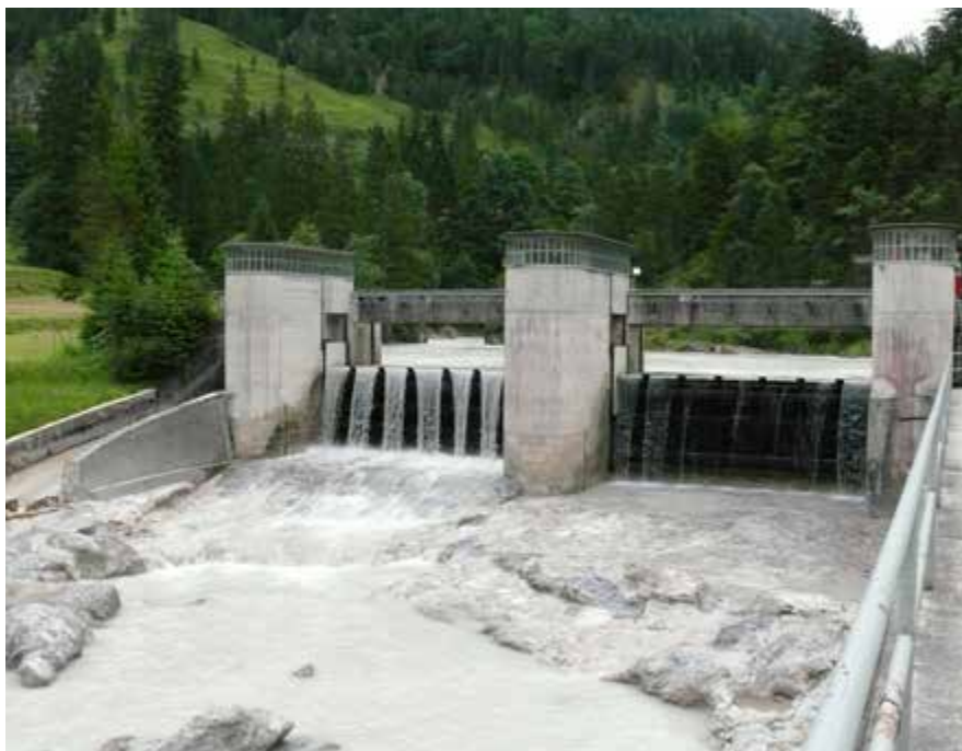
Abb. 17: Das geschlossene Reißbachwehr bei der maximalen Ableitung (ca. 12 \text{ m}^3/\text{s} ) und bereits minimalem Wehrüberlauf. Zum Aufnahmezeitpunkt am 04.07.2008 wurde am Pegel Reißbachklamm ein durchschnittlicher Abfluss von 15,2 \text{ m}^3/\text{s} verzeichnet. (Foto: Reich 2008).
